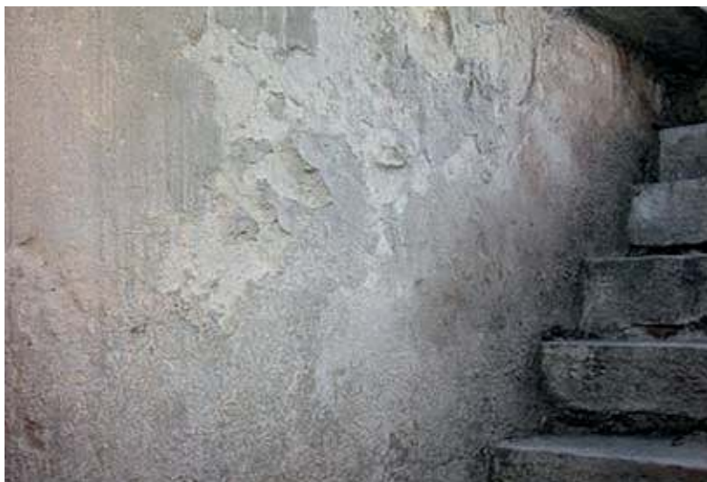
Kellerabgang mit Salzausblühungen und Putzablösungen
