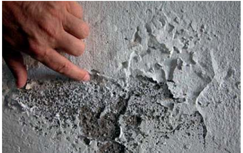
Deckputz- und Farbablösungen durch austretende Salze
