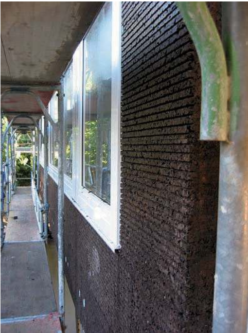
Korkplatten als Wärmedämmung.
